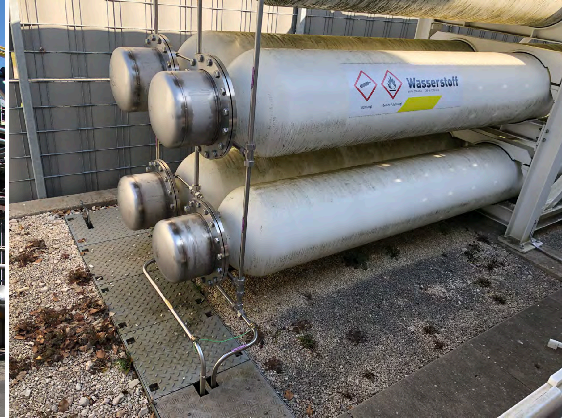
Wasserstoff-Speicher an einer Tankstelle (efficientics)
