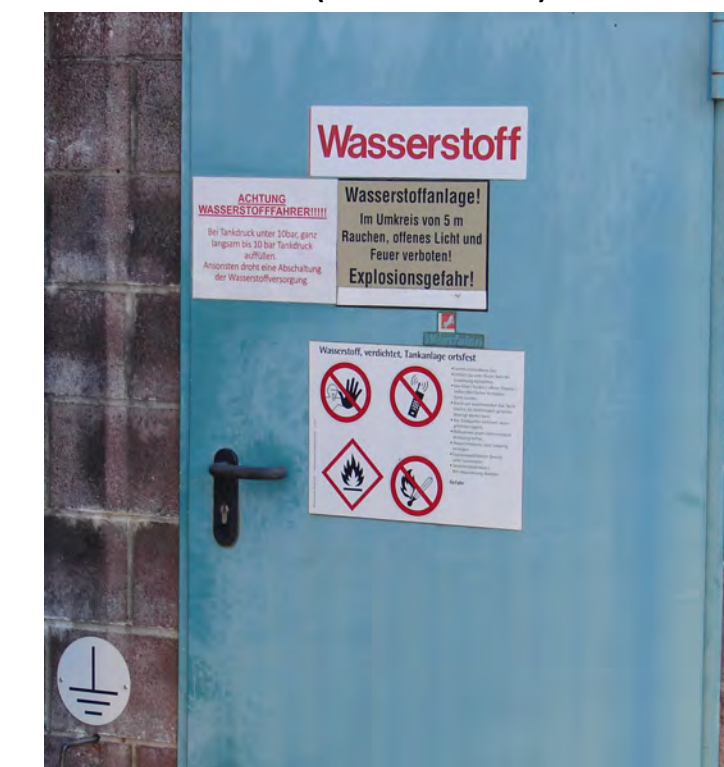
Sicherheits- und Warnhinweise an einer Wasserstoffanlage (efficientics)
