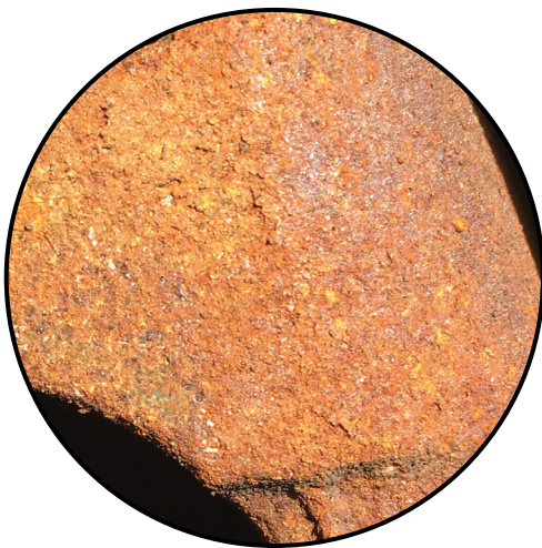
Corrosión General (o Uniforme)
